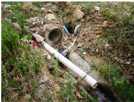
Foto 03 –Registro de ligação clandestina de esgotos no rio Pequeno – Coordenadas 22°54'54,8"S e 43°25'18,8"O–Rio de Janeiro (RJ), 26/10/2015.
