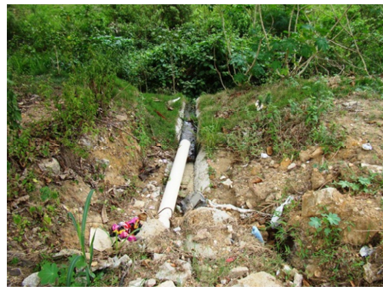
Foto 04 – Registro de ligação clandestina de esgotos no rio Pequeno – Coordenadas 22°54'54,8"S e 43°25'18,8"O–Rio de Janeiro (RJ), 26/10/2015
