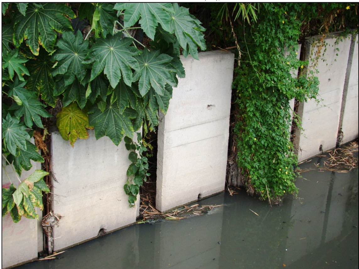
Foto 19 – Rio Pechincha. – Fixação incompleta de placas de concreto.–Coordenadas 22°55'53,4"S e 43°21'49,2"O–Rio de Janeiro (RJ), 26/10/2015.
