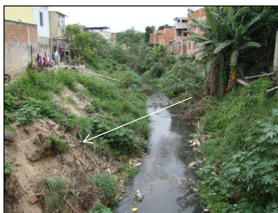
Foto 11: Revestimento da calha do rio Grande sob a ponte da estrada do Curumaú, em trecho não executado devido a paralisação das obras. A foto evidencia a origem dos sedimentos depositados nos trechos de jusante. Coordenadas: 22°54'55,0"S e 43°24'05,2"O. – Rio de Janeiro (RJ), 26/10/2015.
