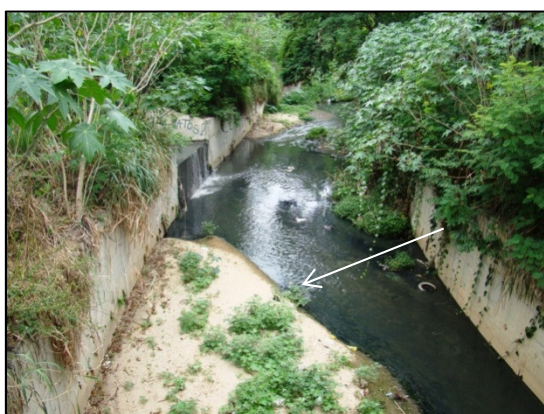
Foto 10: –Depósito de sedimentos em trecho executado no rio Grande, sob a ponte da estrada da Soca – Revestimento em concreto em seção retangular –Coordenadas:22°54'44,4"S e 43°23'16,9"O–Rio de Janeiro (RJ), 26/10/2015.
