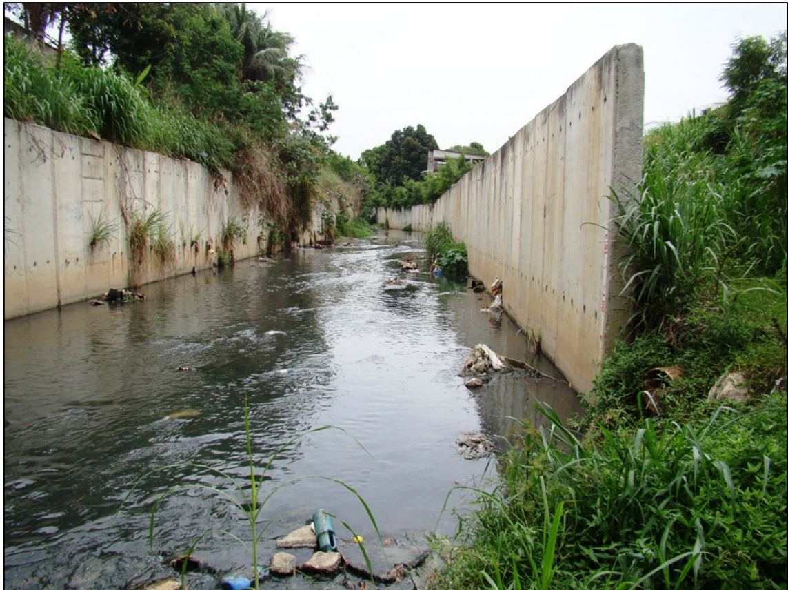
Foto 18 –Rio Grande – Fixação incompleta de placas de concreto. Coordenadas: 22°55'50,5"S e 43°21'59,6"O – Rio de Janeiro (RJ), 26/10/2015
