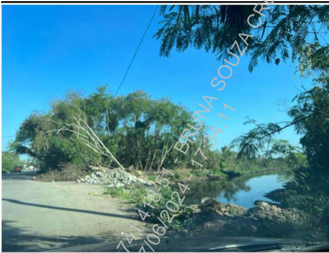
Anexo 2.3: Mostrando a proximidade entre as margens da Av. Engenheiro Souza Filho e Córrego após intervenção da Prefeitura do Rio de Janeiro.
