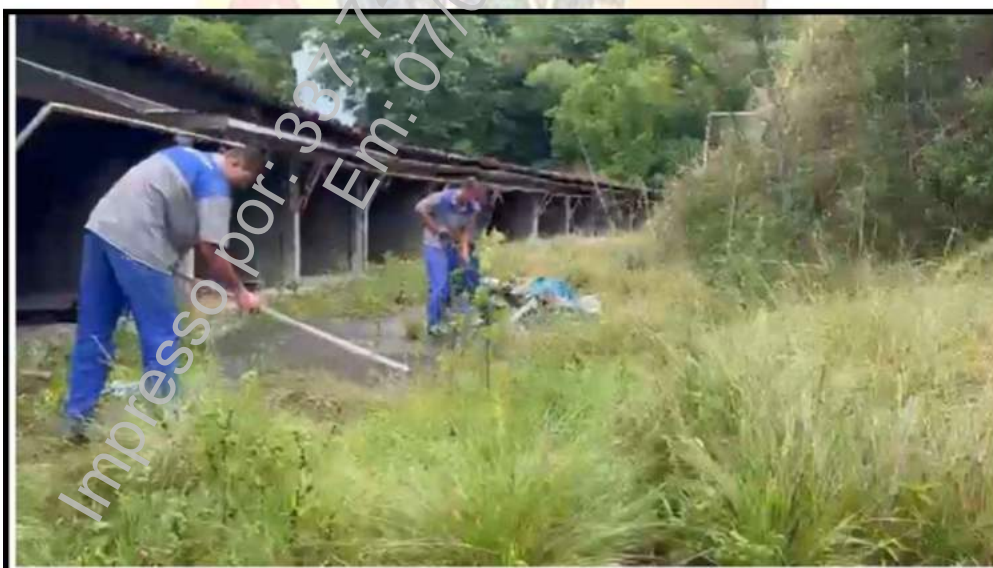
Anexo 6: mostrando o início dos trabalhos, execução da capina na via de acesso em frente ao local apontado pelo colaborador RONNIE LESSA.
